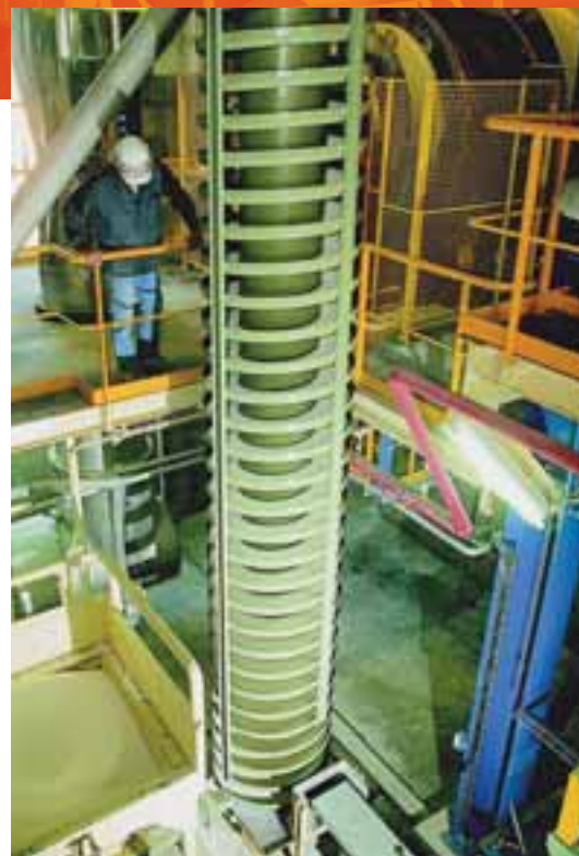
Dans l'atelier de fabrication de catalyseurs KATI, cet élévateur qui achemine les adsorbants sert à la fois de moyen de transport et de refroidissement.
